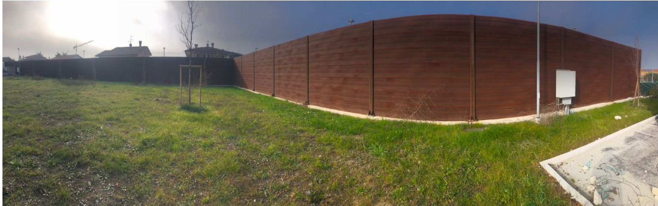
foto barriera esistente
